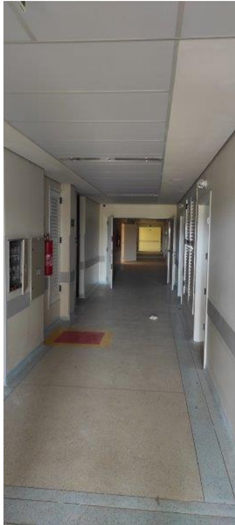
Corredores internos onde os vãos das portas deverão ser ajustados
